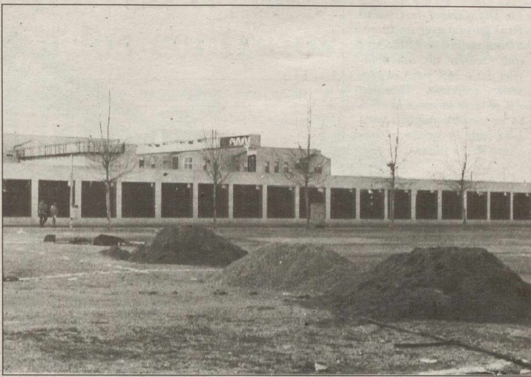
Las obras para el pabellón donde se instalará la Feria ya han comenzado.
