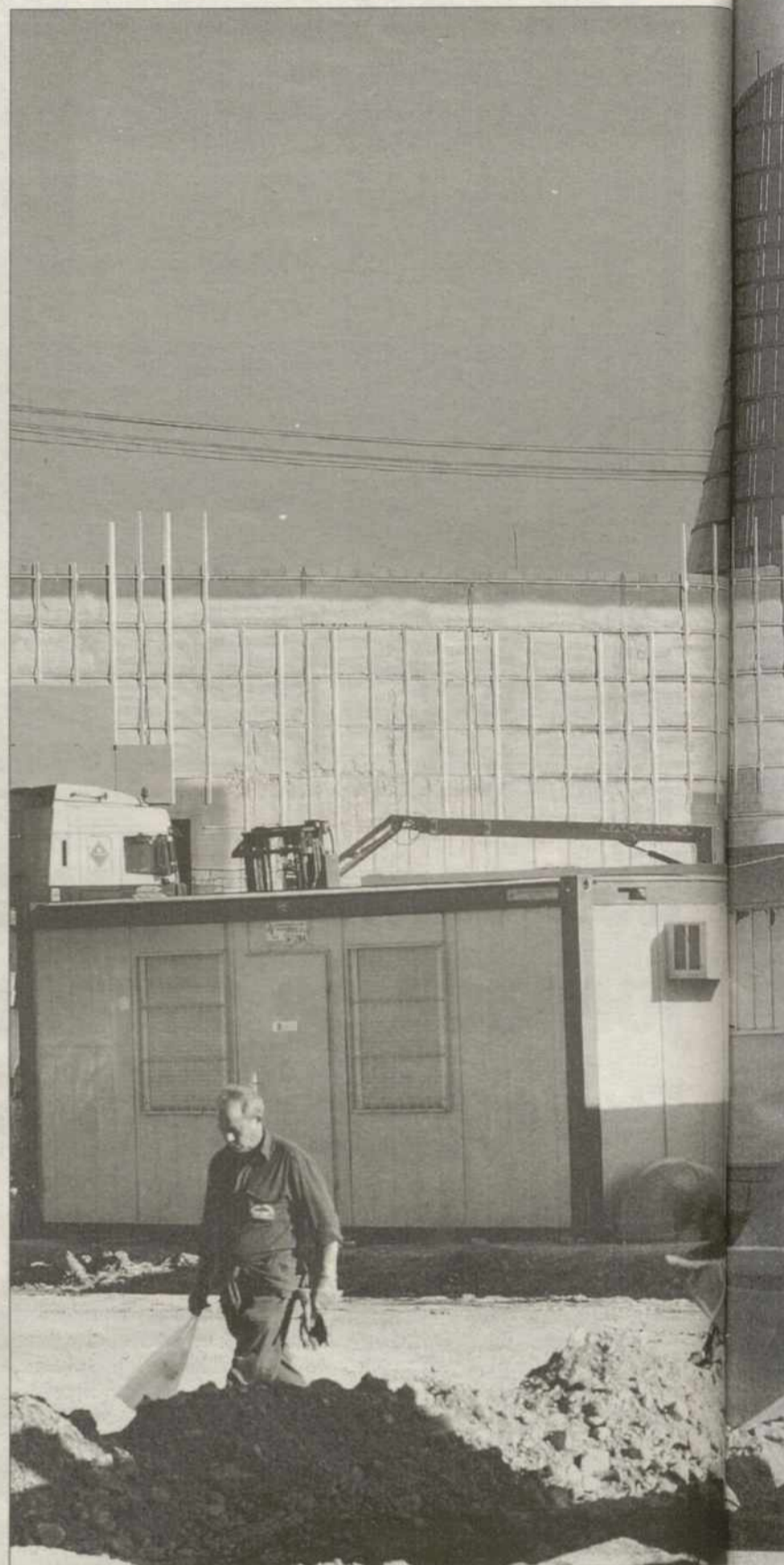
Las obras siguen paralizadas en su totalidad. / R. VIADERO
