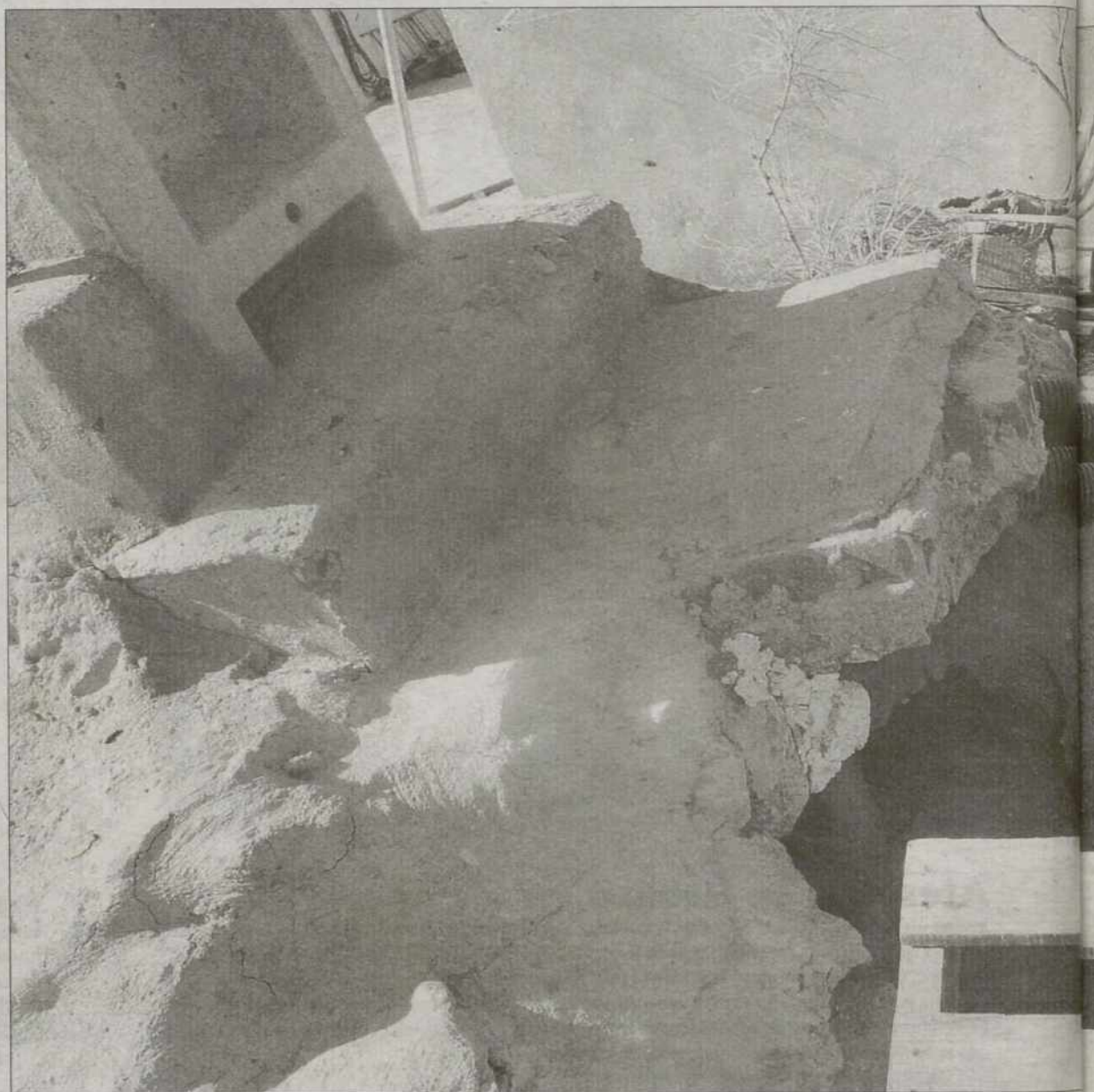
Parte de las instalaciones del centro de protección de perros de Toledo están deterioradas./EVA GARRIDO
