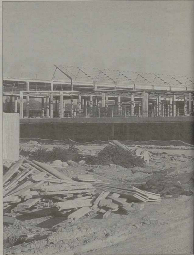
Las obras del futuro complejo comercial avanzan a buen ritmo. / R. VIADERO
