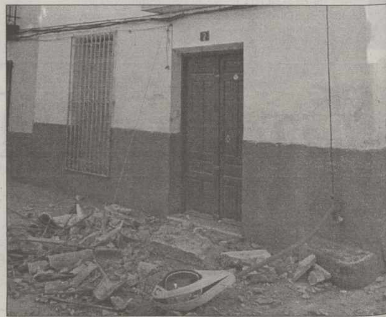
Restos de una cornisa desprendida ayer en Murcia.
