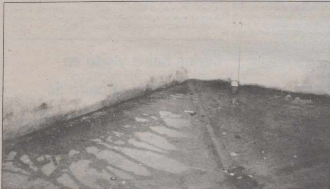
La humedad demuestra deficiencias de acabado en las viviendas de protección oficial de Villada
