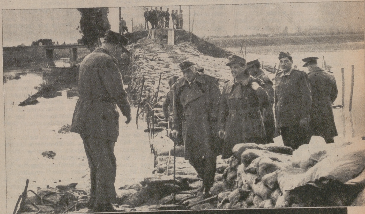
Unidades del Ejército, con el general Castejón al frente, realizan los primeros trabajos de reparación
