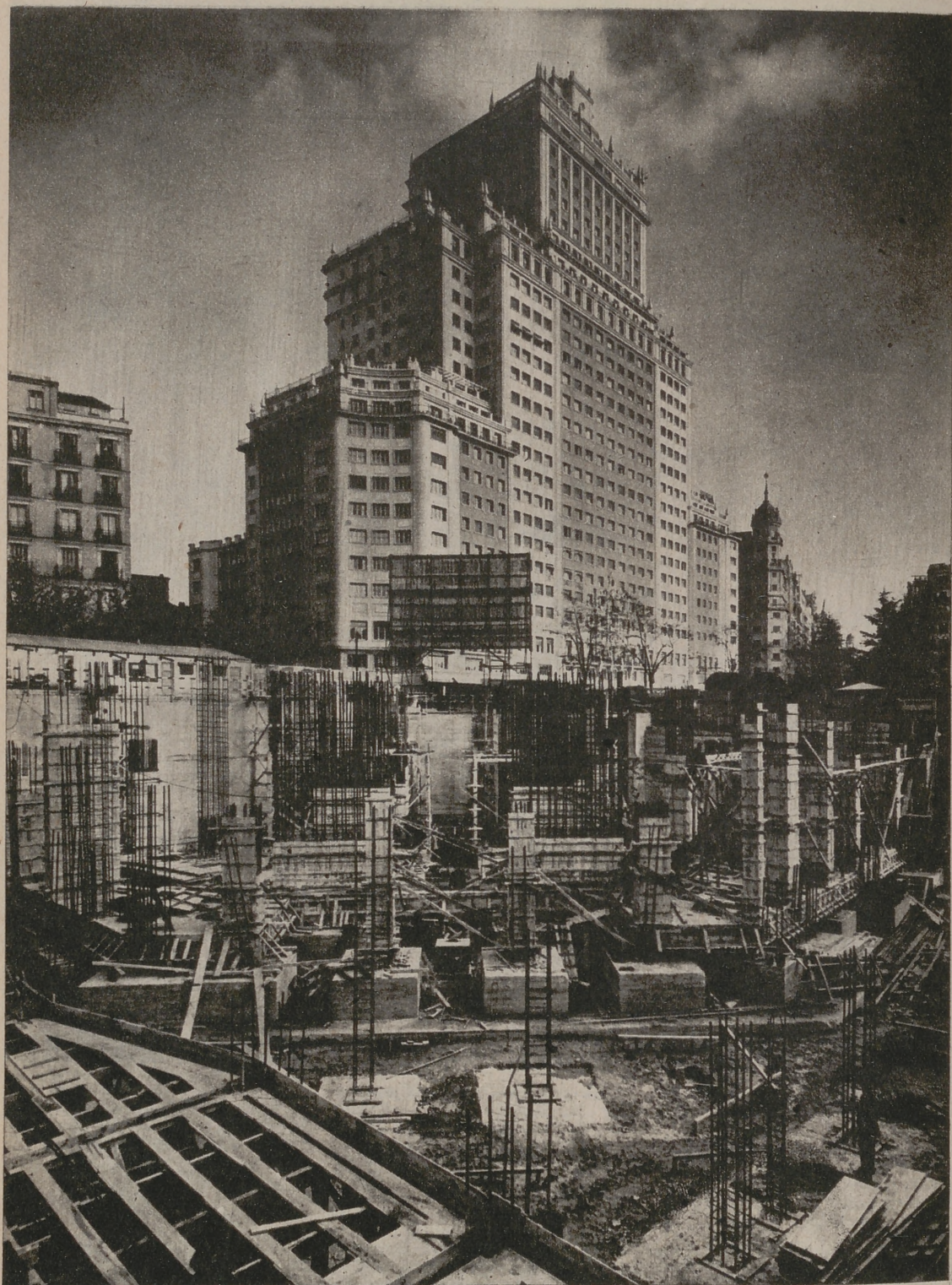
En primer término, la iniciación de las obras de la Torre de Madrid. Al fondo, el Edificio España
