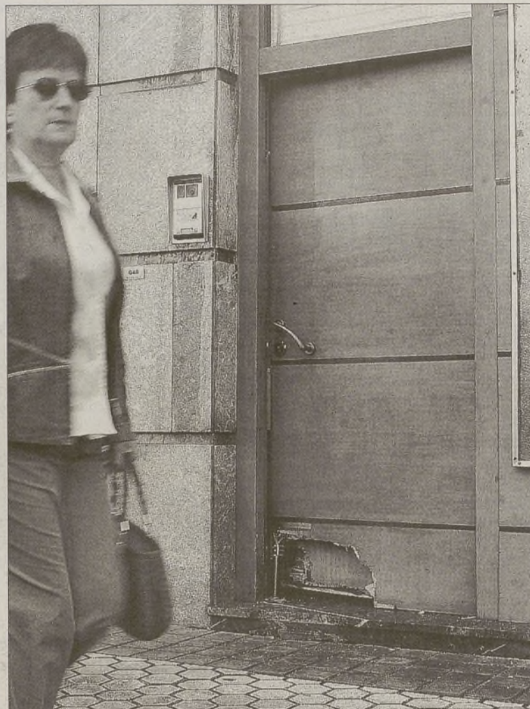
La bomba causó daños en la zona inferior de la puerta de la inmobiliaria. / EFE
