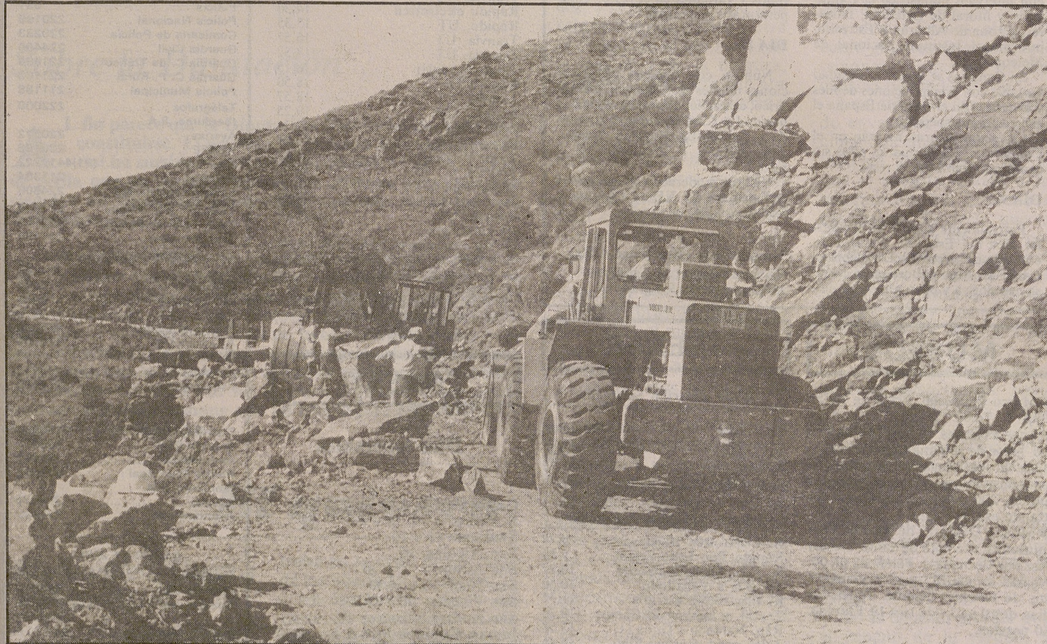
La calzada del Puerto del Pico se desplomó cerca de la curva en la que se inicia el camino a San Esteban del Valle.
