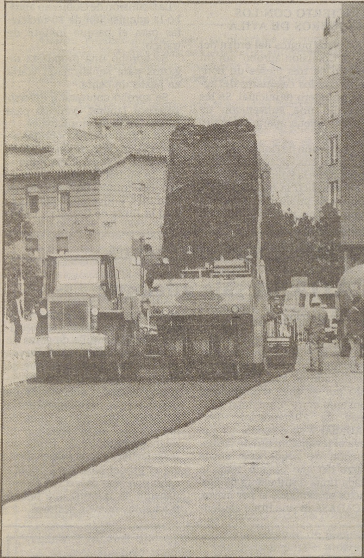
El paseo de San Roque también recibió una nueva capa de riego asfáltico LUMBRERAS
