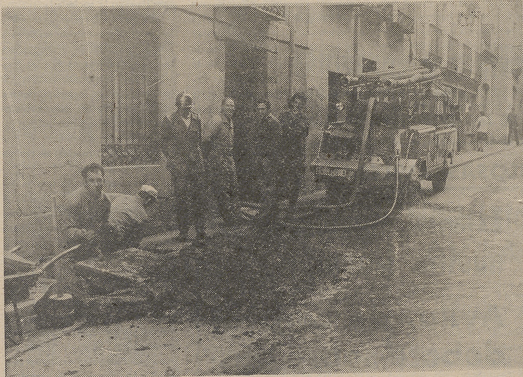
Una fuga de aguas, ocasionó la inundación de varios sótanos de las casas de la calle de Caballeros. El servicio de bomberos y obreros del Ayuntamiento trabajan para averiguar de dónde proviene la avería.—(Foto: MAYORAL).
