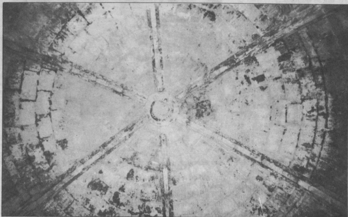
Las filtraciones de agua son tan importantes que el interior de la bóveda gotea en los días de lluvia.
