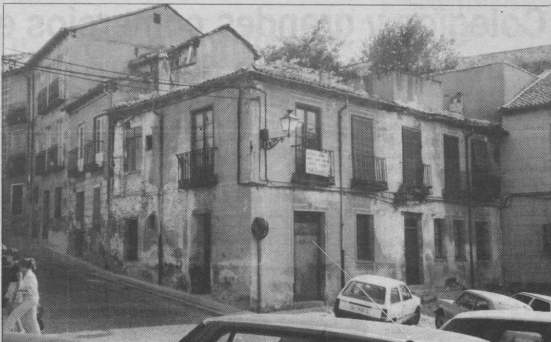
La calle Ochoa Ondátegui pide una urgente rehabilitación.
