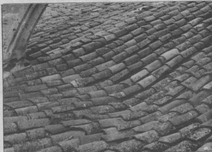
La cubierta de teja se ha hundido ligeramente.
