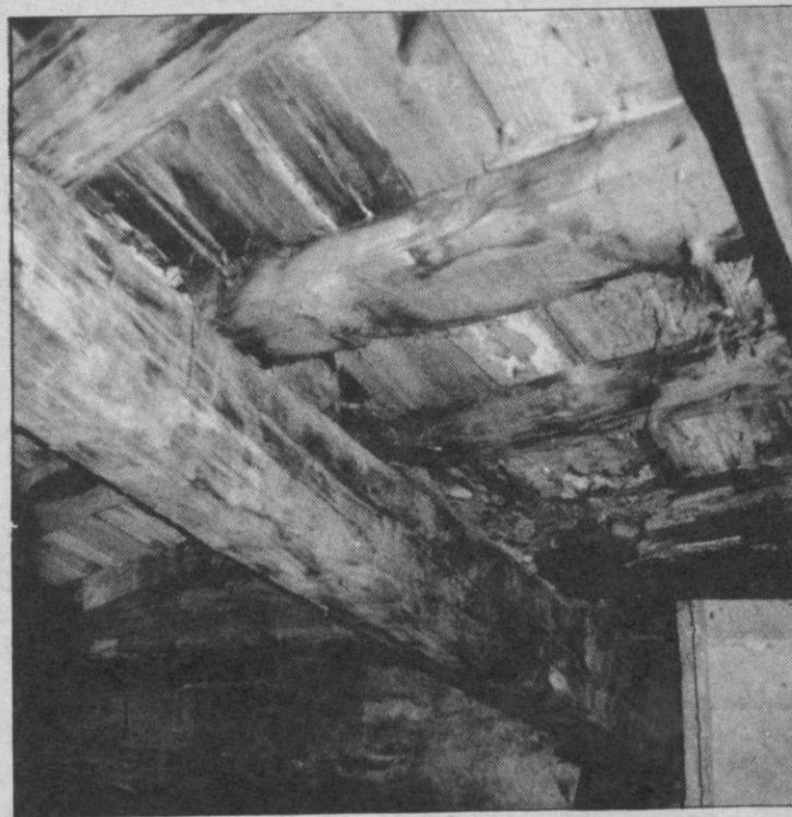
La madera ha sufrido daños por el efecto de los xilófagos.
