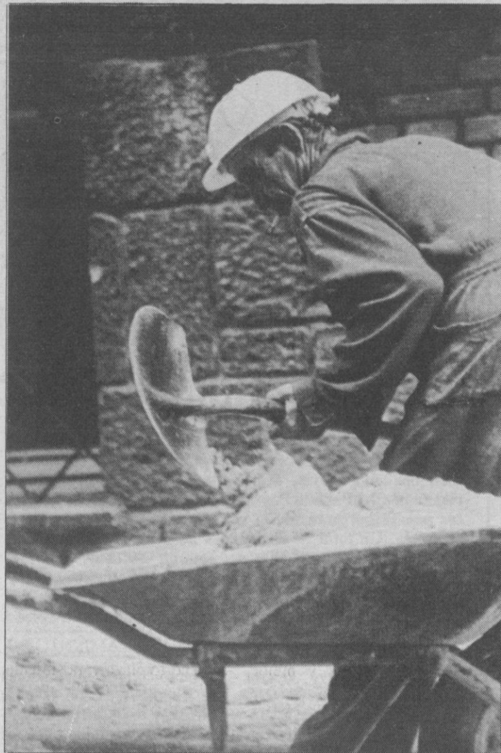
1.595 accidentes ocurrieron en la construcción entre 1987 y 1992.
