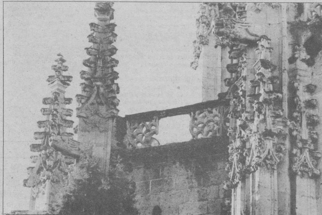
Pináculos y cresterías son una prueba evidente del deterioro de la catedral
