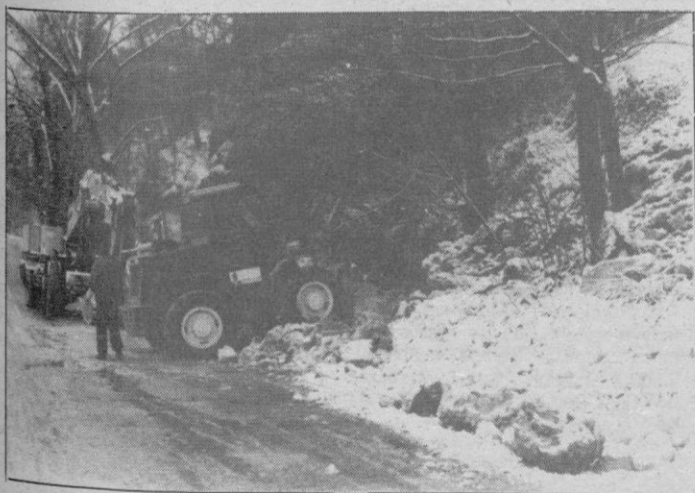
Retirada de los cascotes de la carretera, que quedó cortada por su presencia.
