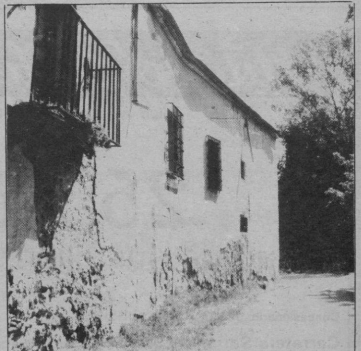
En algunas partes su estado es casi ruinoso
