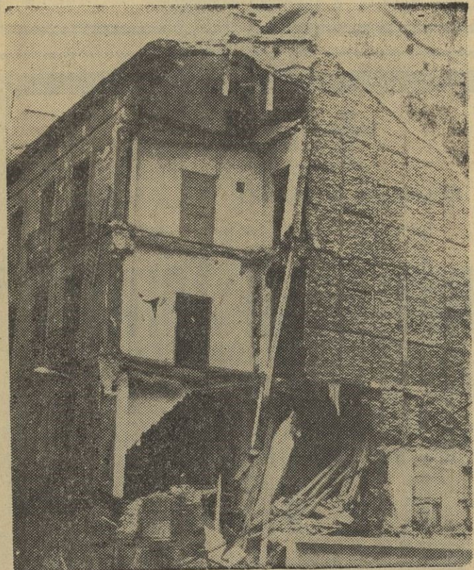
En la fotografía de Guarner puede apreciarse la magnitud del derrumbamiento, que fué muy espectacular.
