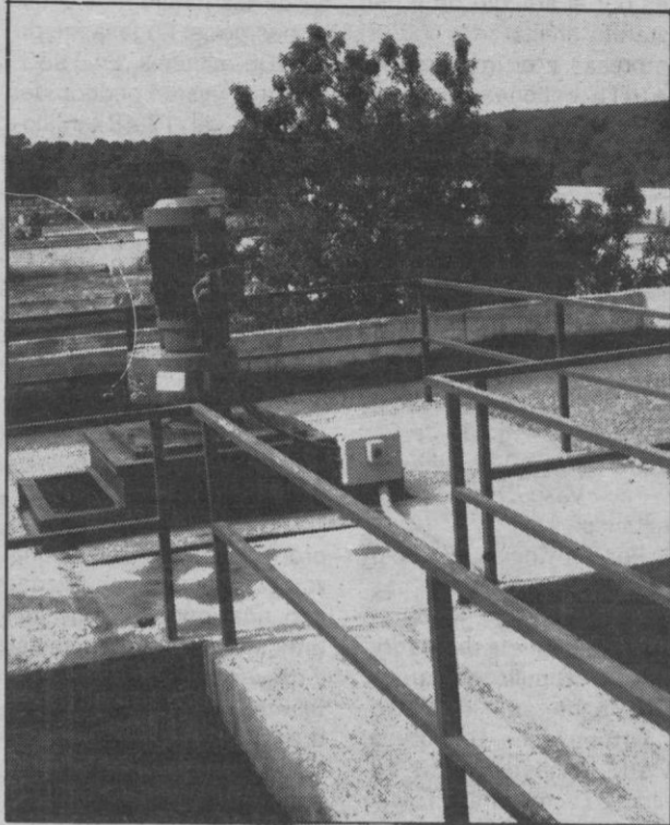
La depuradora arenalense, con sus nuevas turbinas para tratamiento de fangos.
