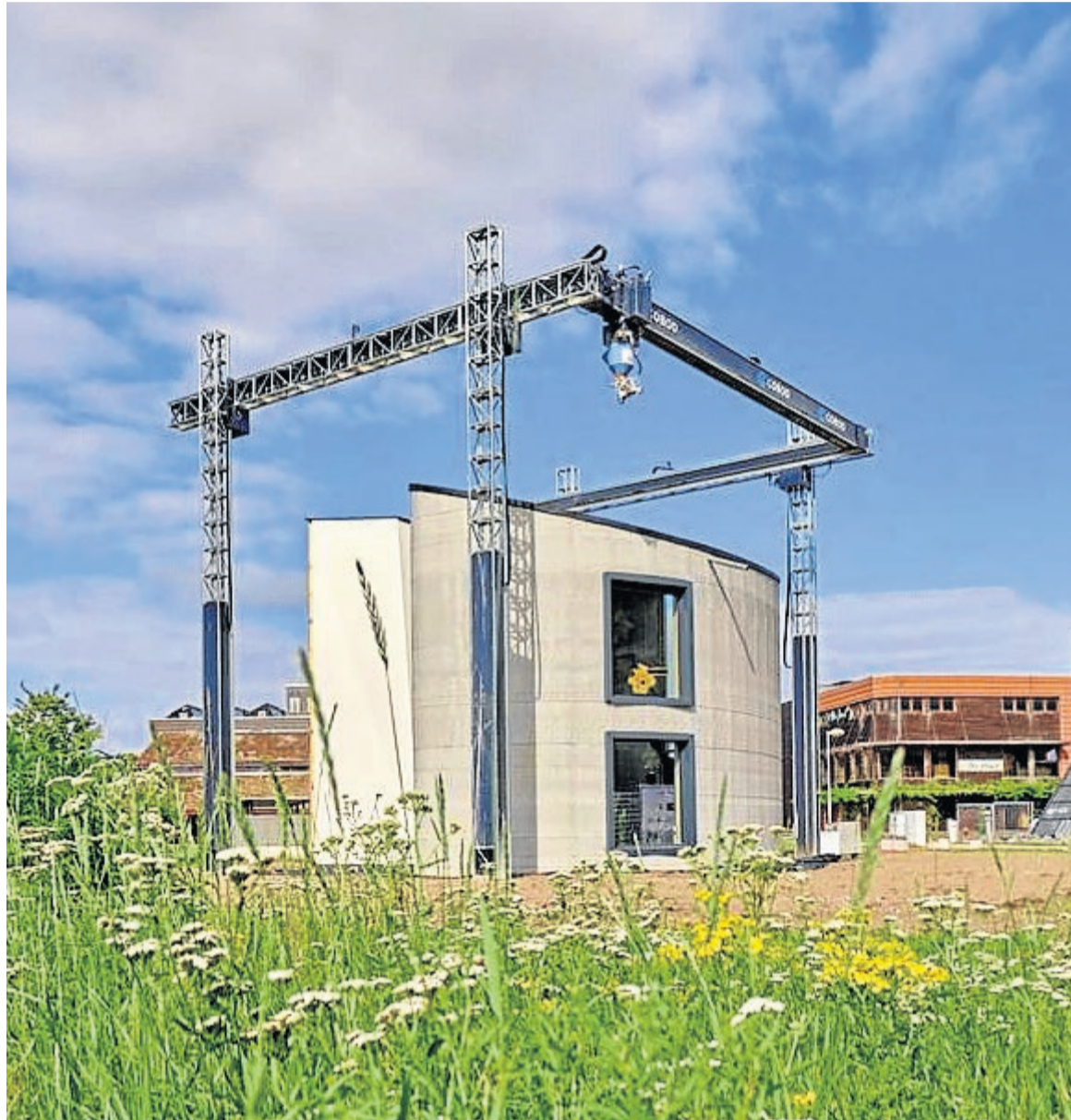
Primera casa impresa por la tecnología 3D de varias alturas en Westerlo, en la región de Flades, Bélgica.
