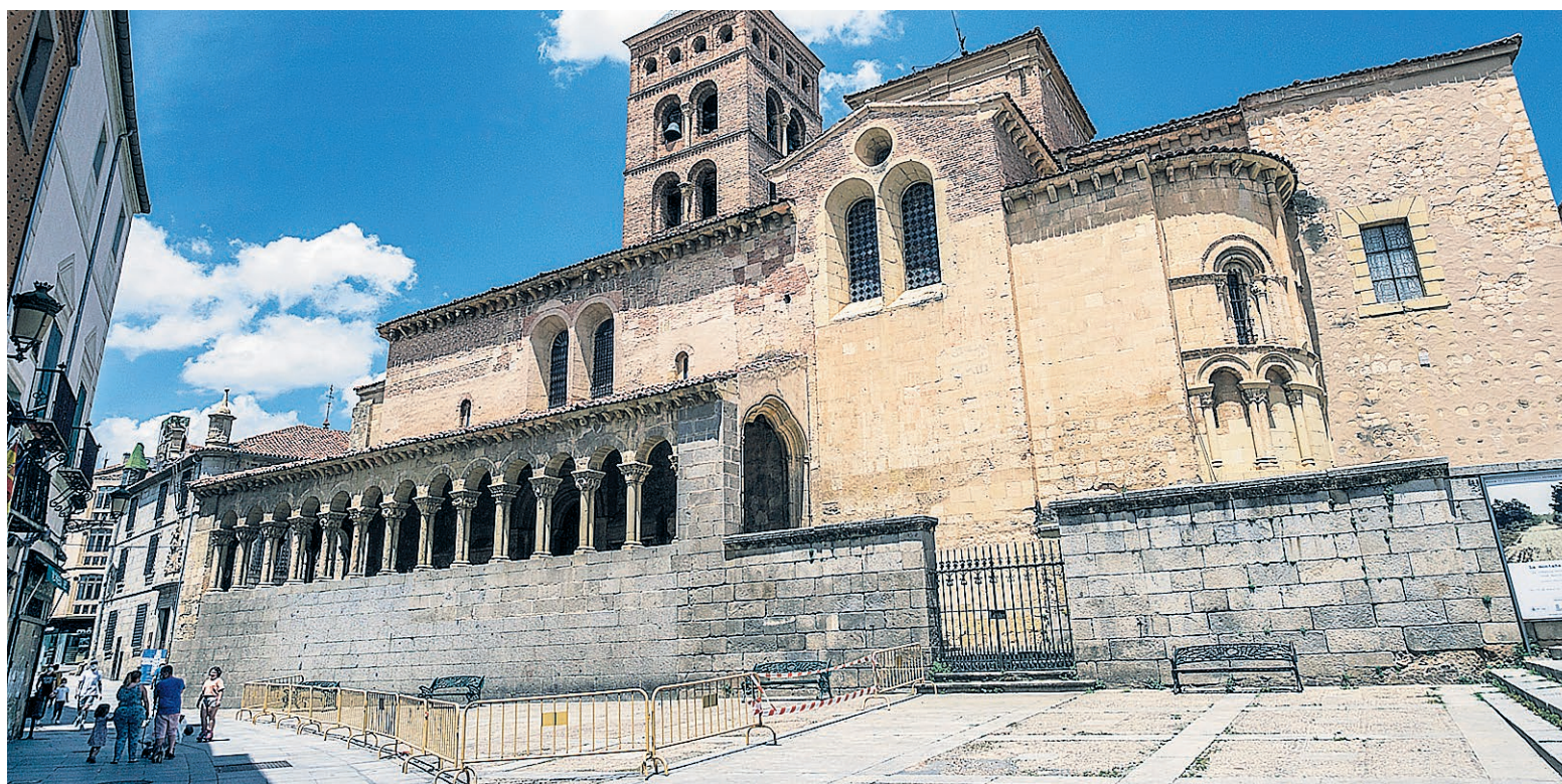
La zona más próxima a la torre tuvo que ser acordonada para evitar el peligro del desprendimiento.
