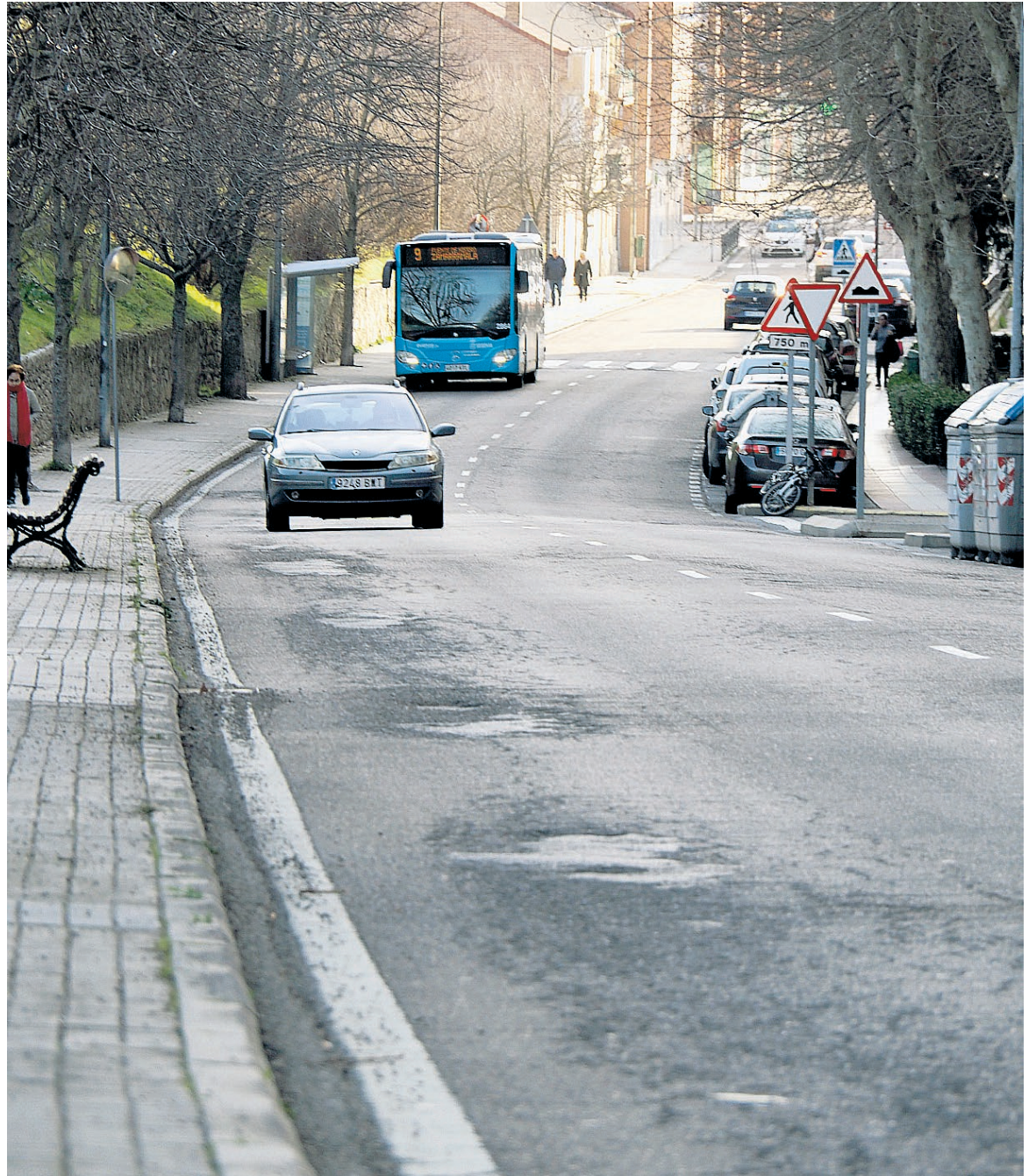
Estado de uno de los tramos de la carretera de Villacastín en el barrio de Santa Teresa-El Puente de Hierro. N. LLORENTE
