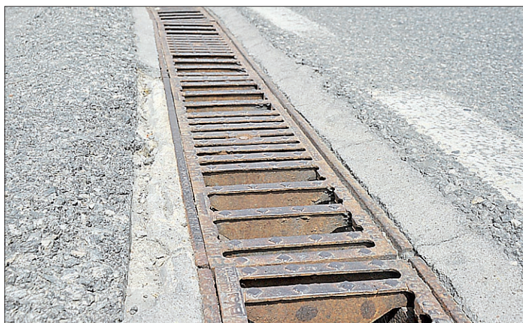
El sistema de recogida de agua de lluvia de la carretera de Valladolid se ha revelado insuficiente y multiplica los problemas en esta zona de la ciudad. / K.
