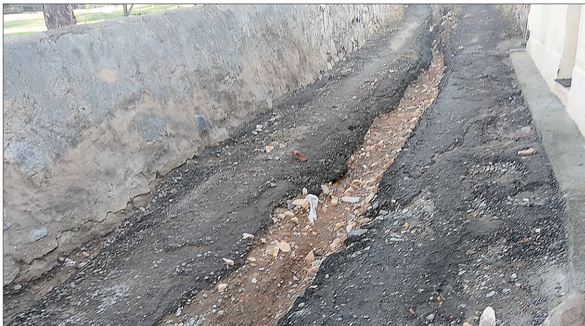
La tormenta de la noche del 8 de julio generó un torrente de agua que arrastró el pavimento de tierra y gravilla. / E. A.
