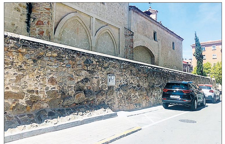
Estado actual de la acera anexa al templo. / EL ADELANTADO
