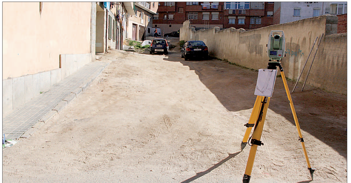
Tramo de la calle San Cristóbal, en San Lorenzo, donde el miércoles comenzaron los primeros trabajos. / NEREA LLORENTE
