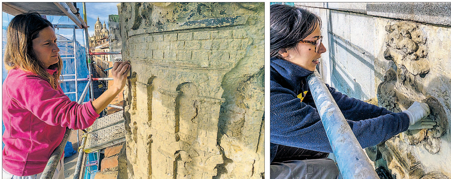
Una restauradora trabaja en la limpieza de uno de los pináculos de la cubierta. A la derecha, otra se dedica a la zona superior del escudo. / E. A.
