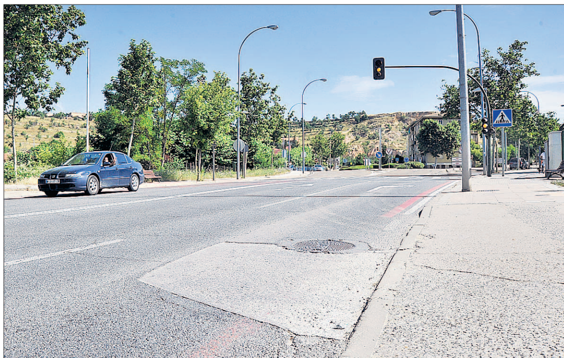
Tramo del puente del río Ciguñuela, en la avenida Vía Roma del barrio de San Lorenzo. / KAMARERO
