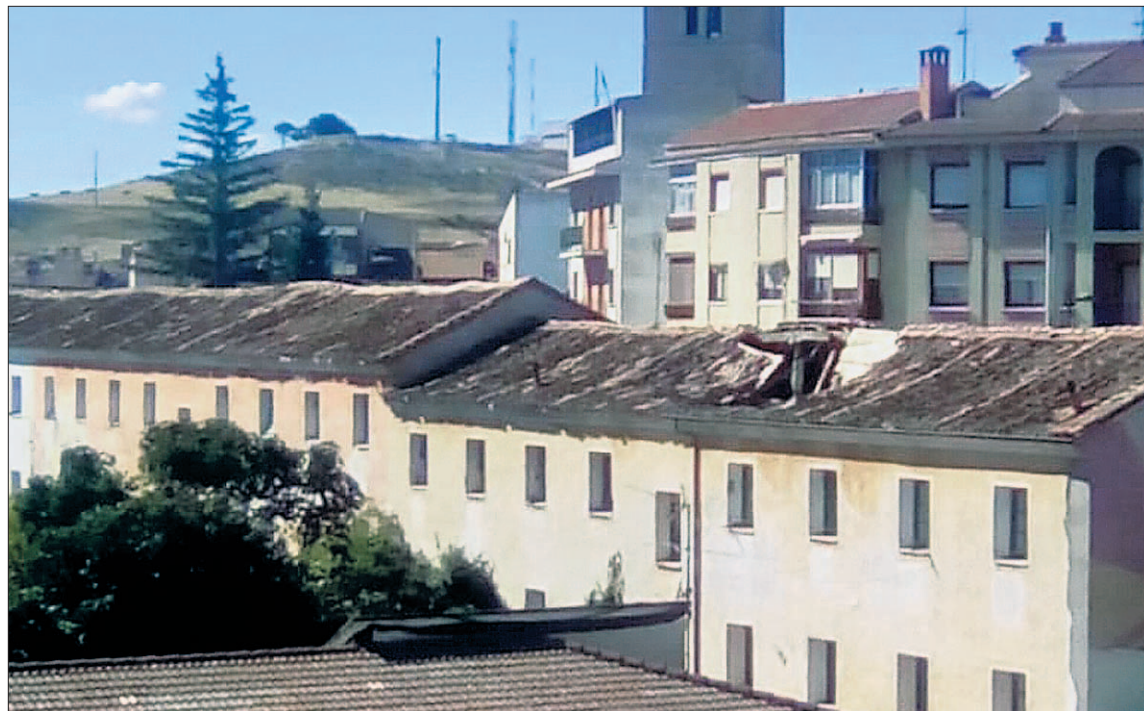
Estado de la cubierta de los edificios que componen "las casas de los maestros". / C. NÚÑEZ
