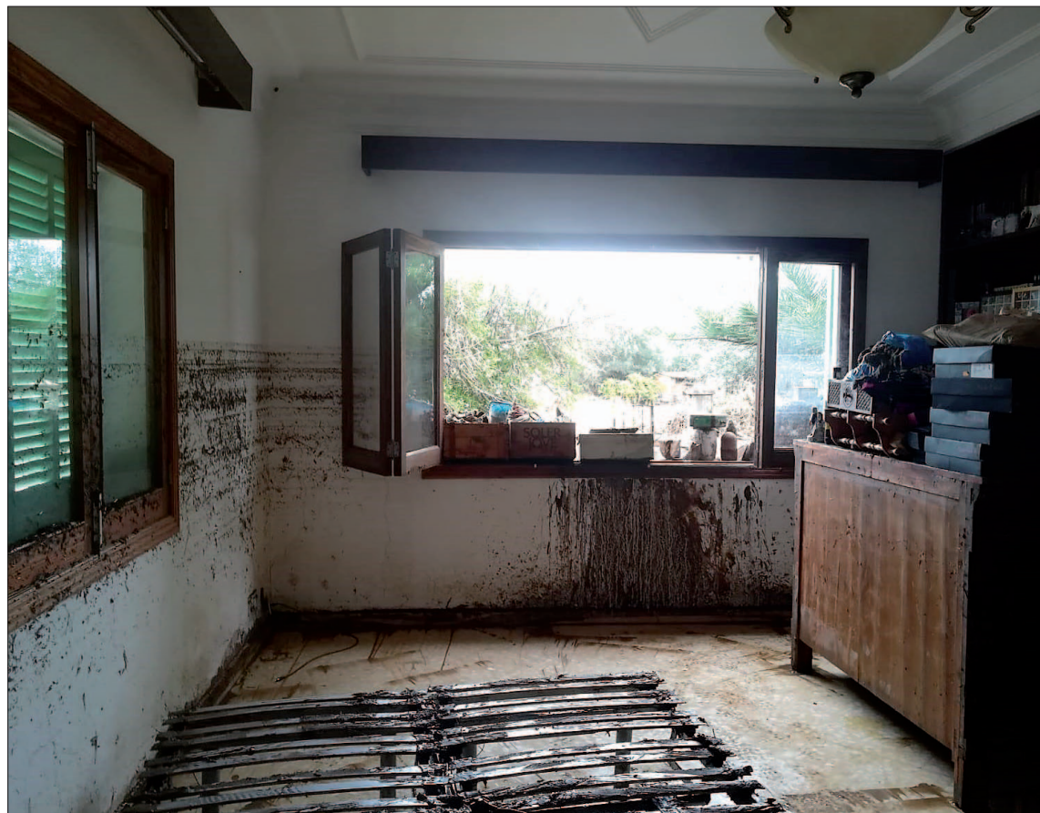
Destrozos en una de las viviendas afectadas por las inundaciones en la isla de Mallorca. / EUROPA PRESS
