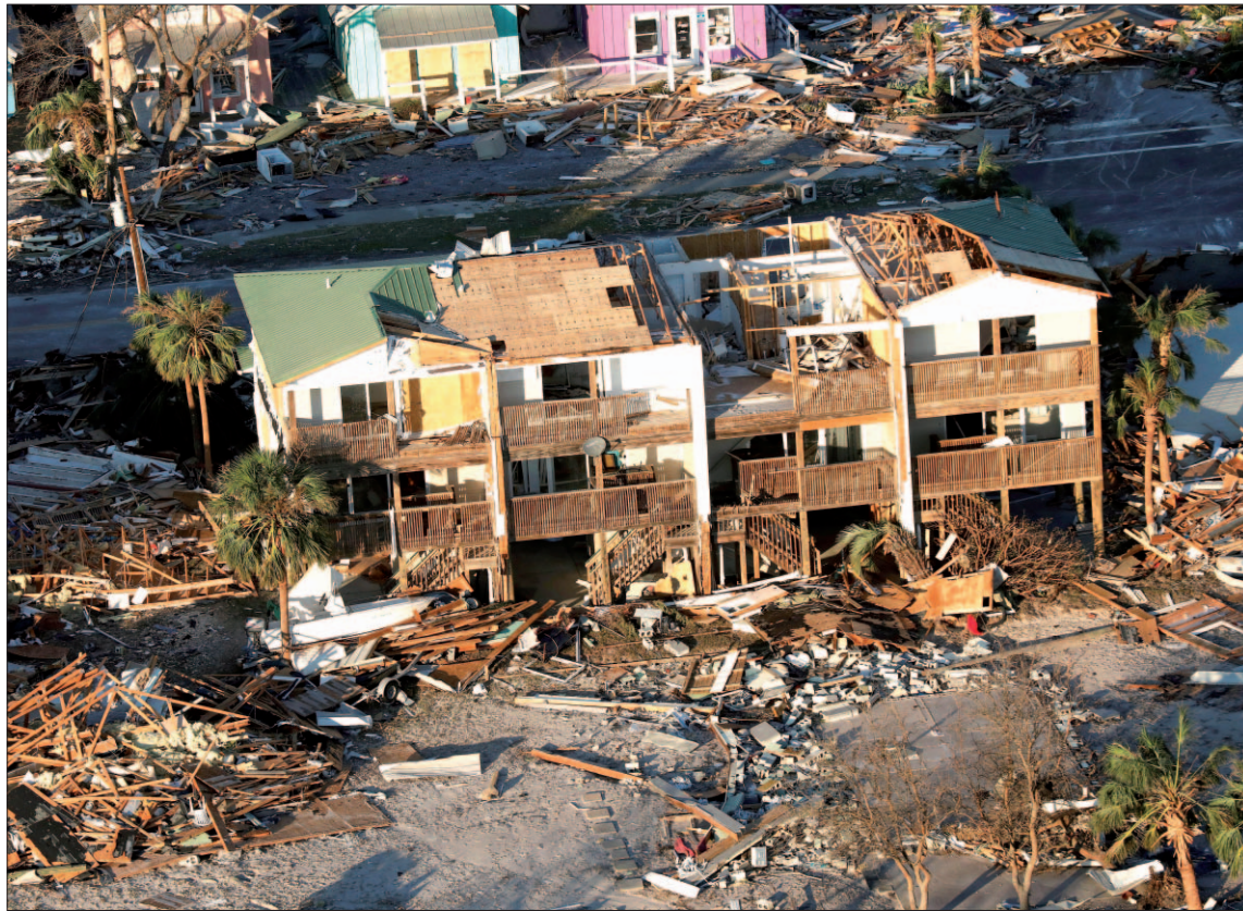
Fotografía aérea que muestra el destrozo ocasionado tras el paso del huracán Michael en Panamá City, Florida. / EFE
