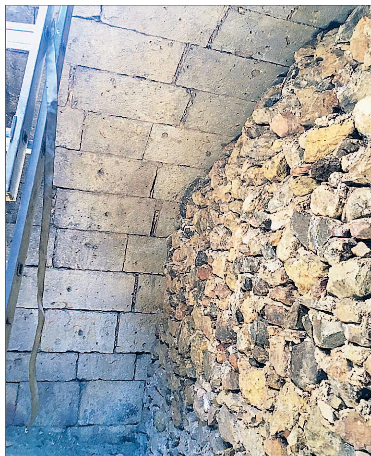
Bóveda realizada con sillares de caliza que ha aparecido en la calle San Juan. / E. A.
