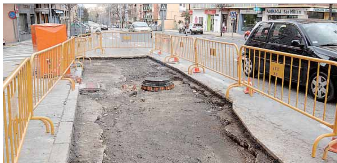
Los trabajadores procederán hoy a cubrir el socavón con hormigón, una vez cambiada la tubería afectada. / NEREA LLORENTE
