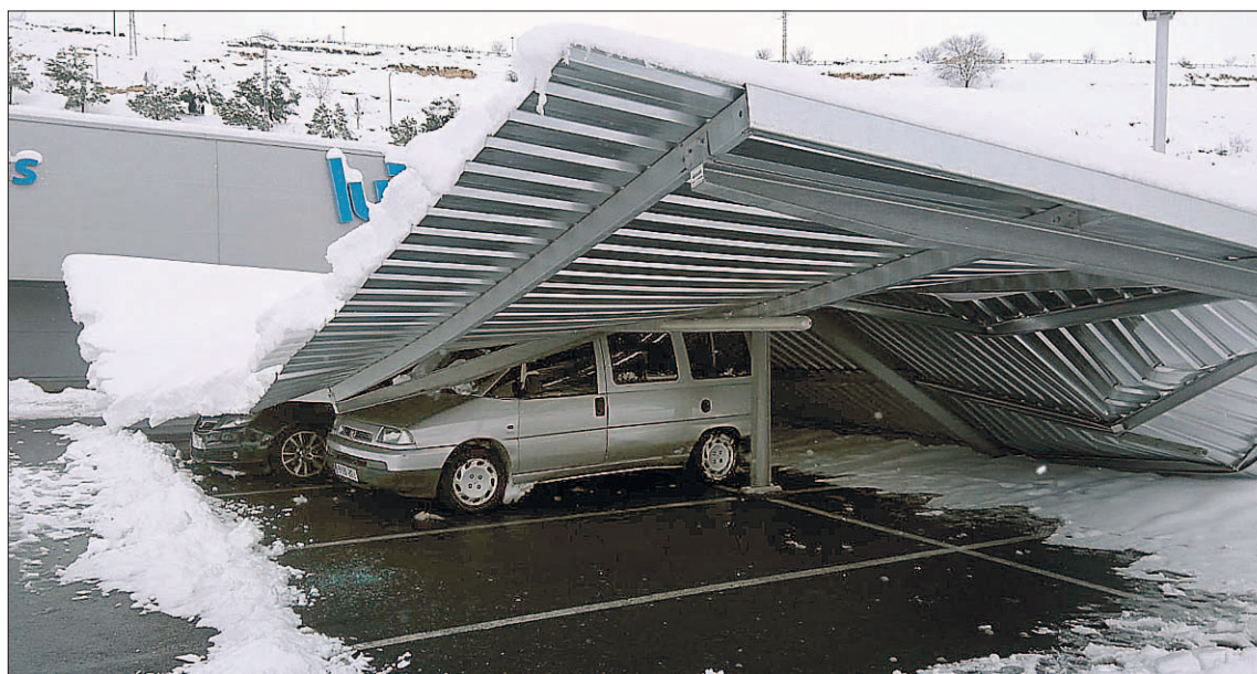
El tejado del aparcamiento del supermercado Lupa cedió por el peso de la nieve acumulada. / EL ADELANTADO
