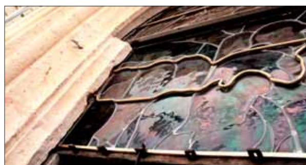
Detalle del estado inicial de una de las vidrieras tras su restauración, vista desde el exterior.
