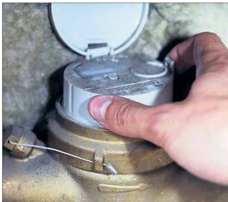
Los lectores de contadores están todos identificados. / KAMARERO
