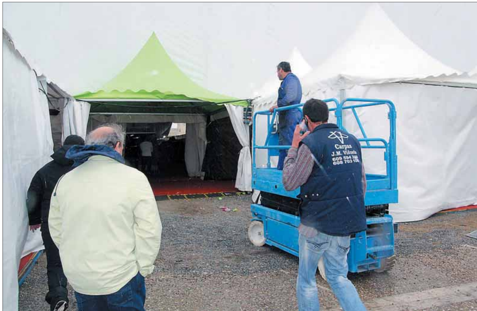
La llegada de la plataforma elevadora aceleró el proceso de reparación, ante la presencia de miembros del equipo de Gobierno y operarios municipales. / C. N.
