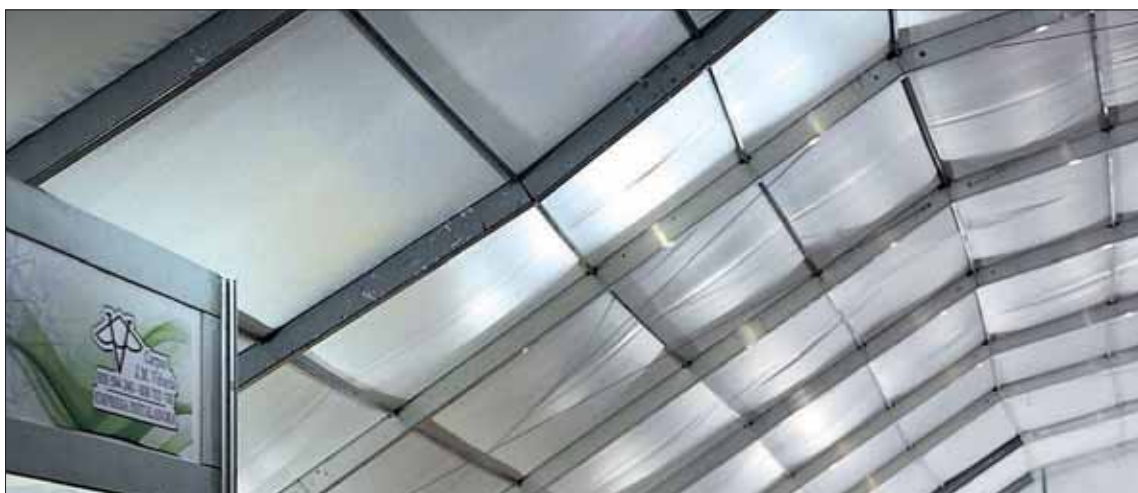
La estructura dañada en dos de sus vigas, fisuradas, provocó el cierre de la feria en la jornada de ayer. / C. N.
