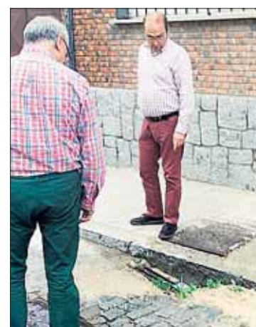
Lugar donde está la fuga./ E. A.
