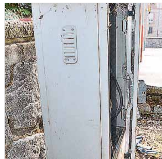
Caja abierta con cableado de acceso a internet. / T. DE SANTOS
