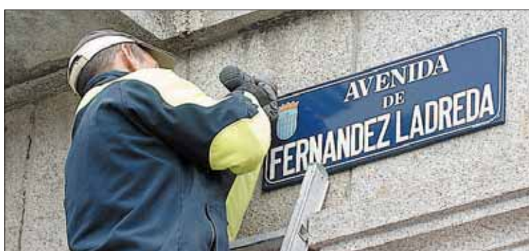
Un operario procede a retirar la placa antigua de una de las fachadas. / J. MARTÍN
