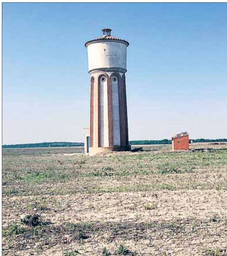
Depósito de agua en Donhierro, uno de los municipios beneficiados. / EL ADELANTADO
