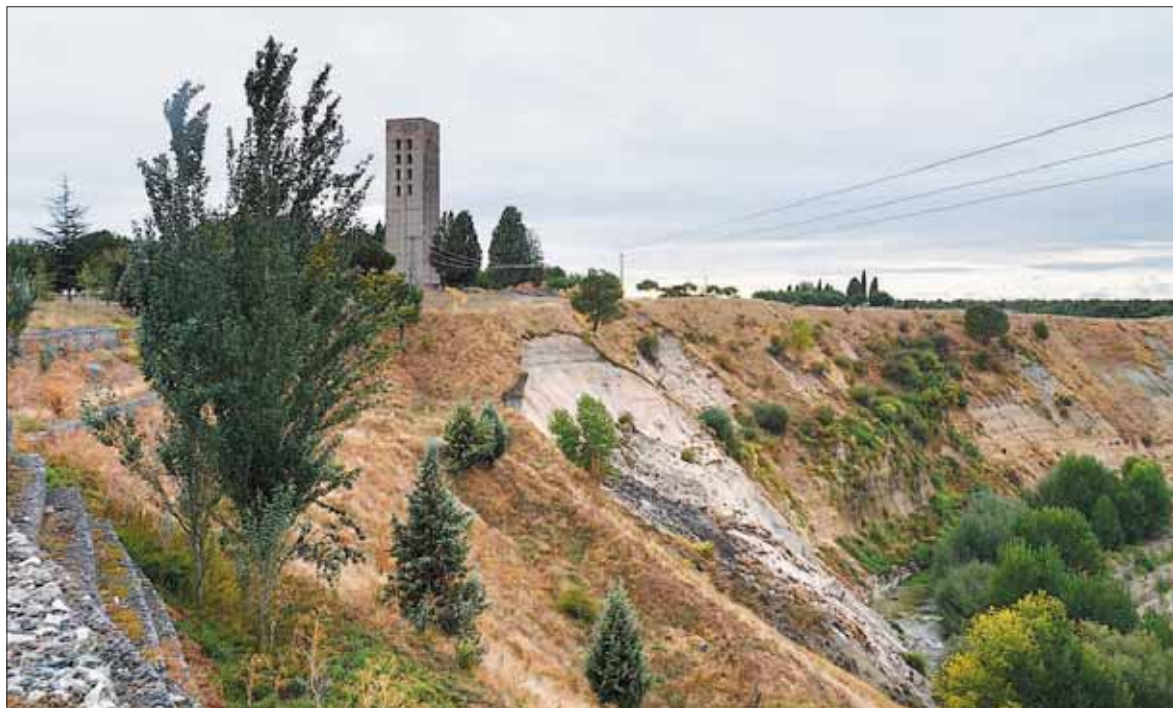
Estado de la ladera cercana a la iglesia de San Nicolás, tras el derrumbe. / DAVID RUBIO - DESCUBRECOCA.COM
