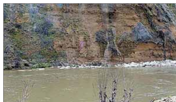
Los populares dicen que en el tramo B (en la imagen) la CHD no siguió el proyecto y se ahorró 300.000 euros. / E.A.
