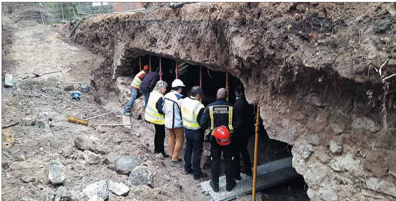
Los bomberos y operarios de la empresa examinaron ayer y consolidaron la zona afectada por el derrumbe. / EL ADELANTADO
