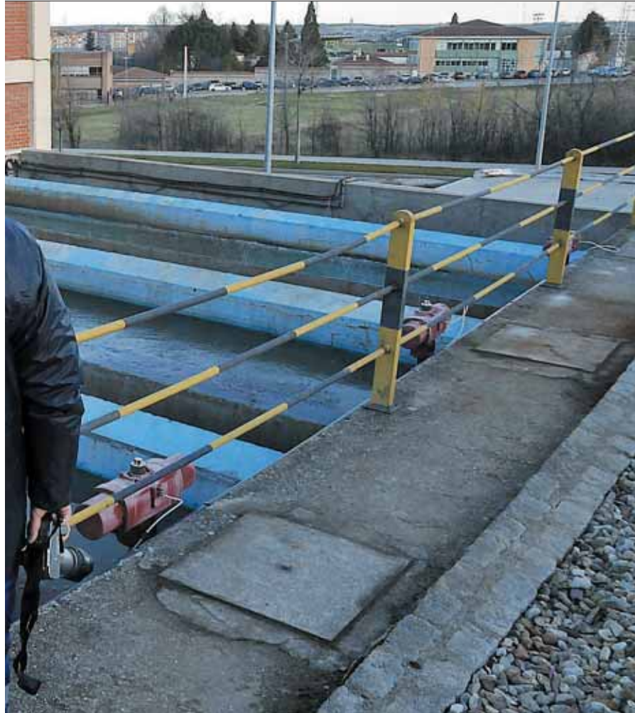
filtros de arena de la ETAP, que pueden verse en la fotografía. / JUAN MARTÍN
