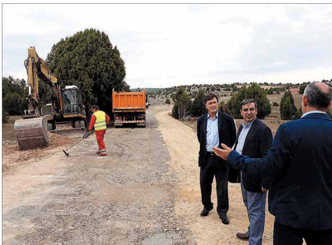
Francisco Vázquez y José Luis Sanz Merino comprobaron 'in situ' el desarrollo de las obras. / EL ADELANTADO
