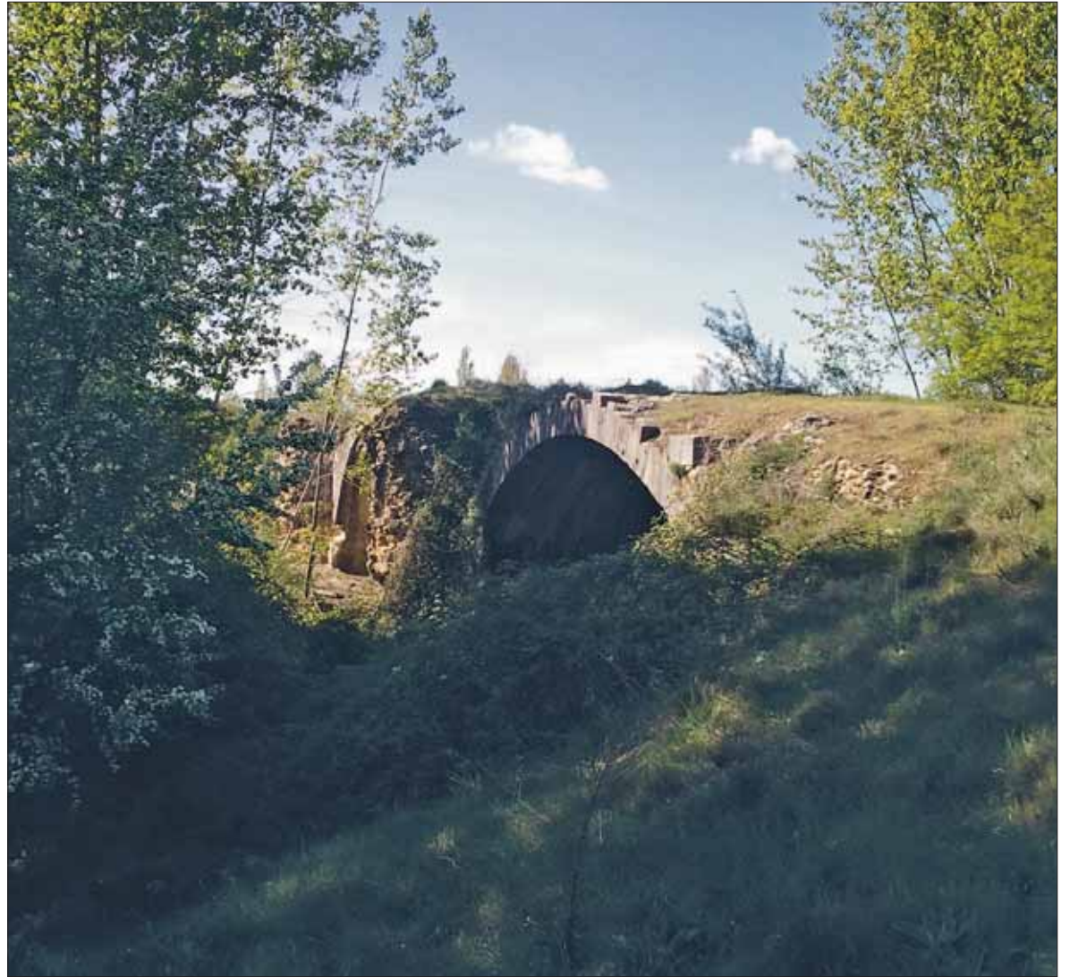
El Puente Blanco de Villahibiera, en la provincia de León, uno de los elementos del patrimonio en peligro. / HISPANIA NOSTRA
