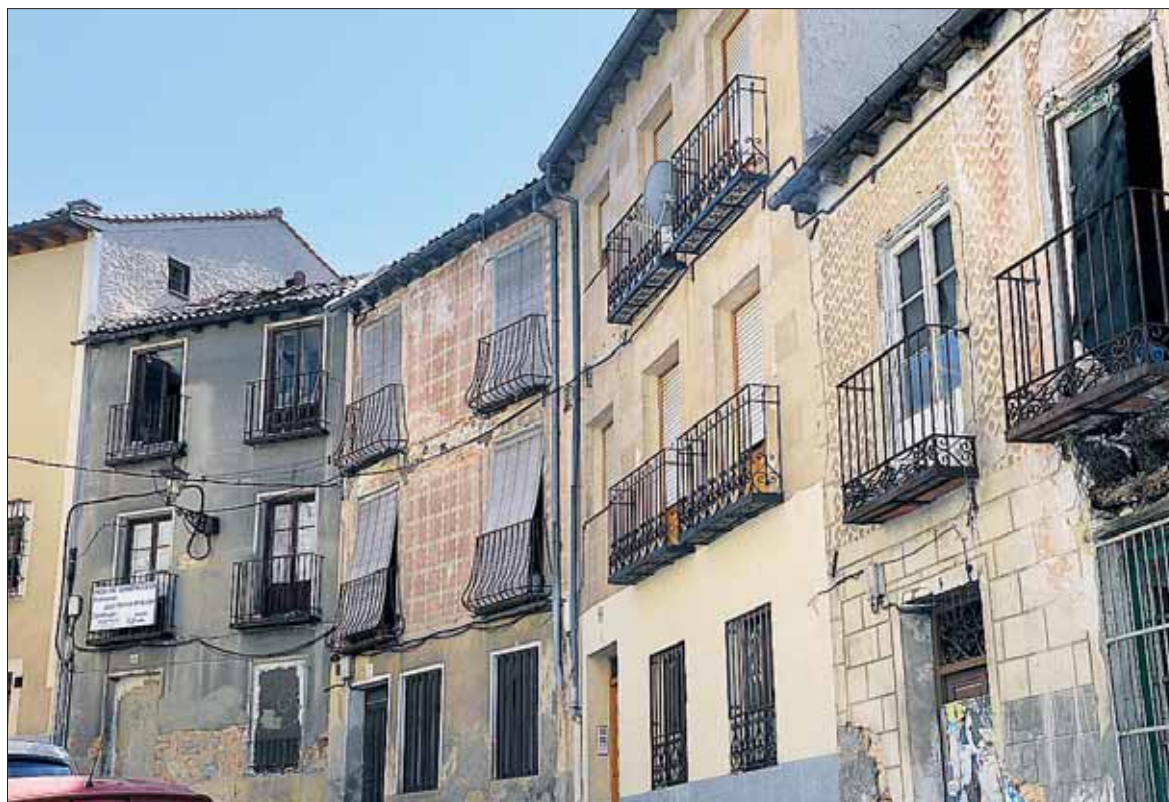
Algunos edificios del barrio se encuentran abandonados y en estado de ruina. / KAMARERO
