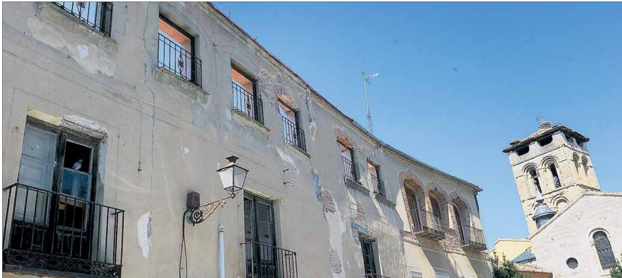
Edificio en ruinas situado junto a la iglesia de San Justo. El programa de ayudas pretende incentivar a los propietarios de inmuebles a invertir en su rehabilitación. / KAMARERO
