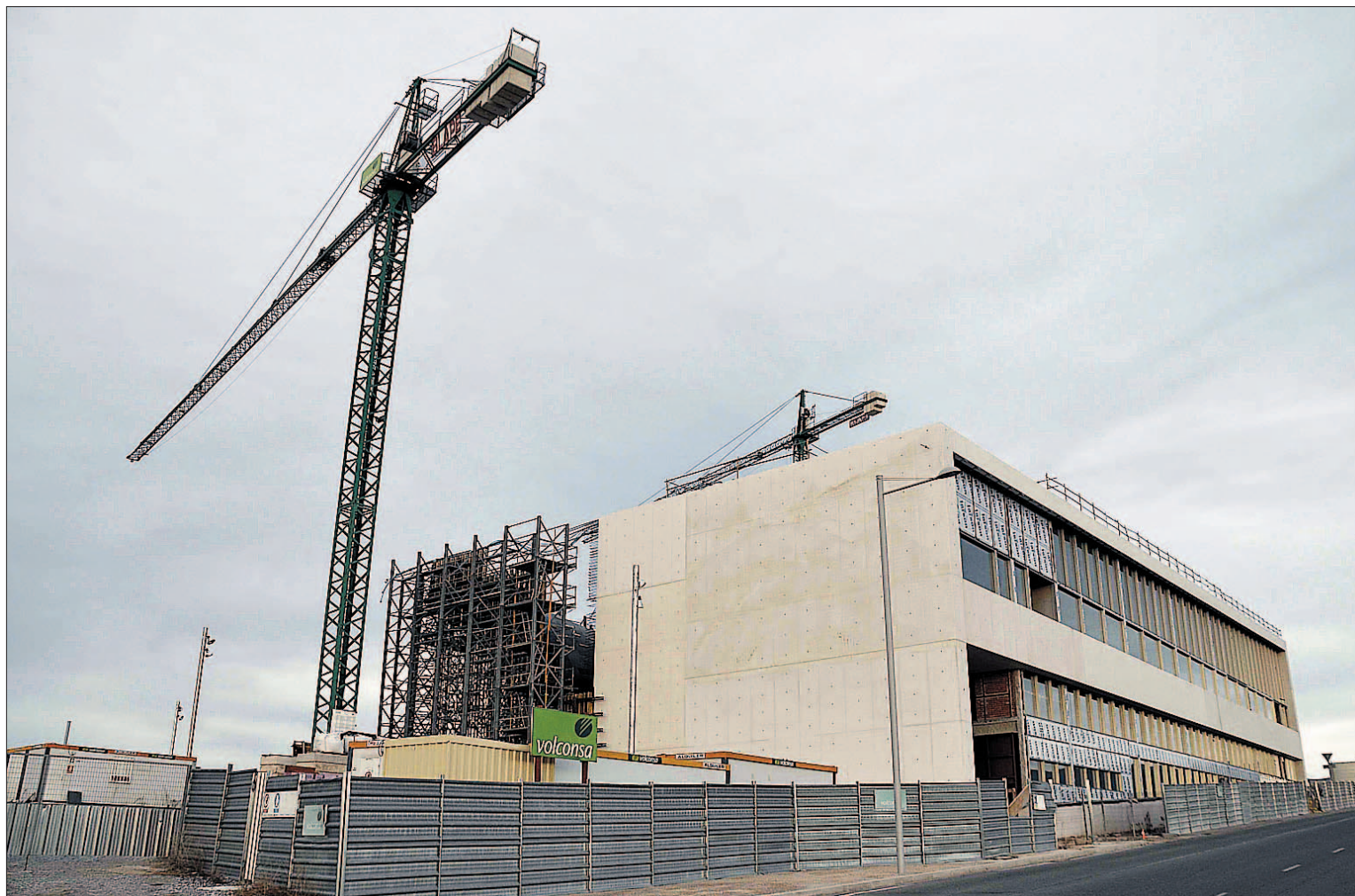
Agotado el último plazo para terminar la obra, el Ministerio rechaza una ampliación y exige la devolución de los 3,8 millones no gastados en el proyecto. / JUAN MARTÍN
