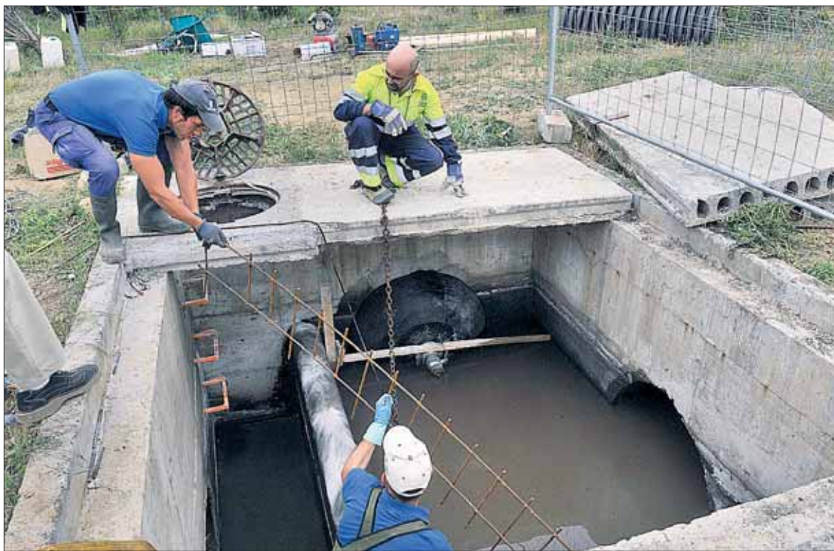
Varios operarios trabajaban ayer para solucionar la avería en el colector cerca del Eresma, en Zamarramala / KAMARERO
