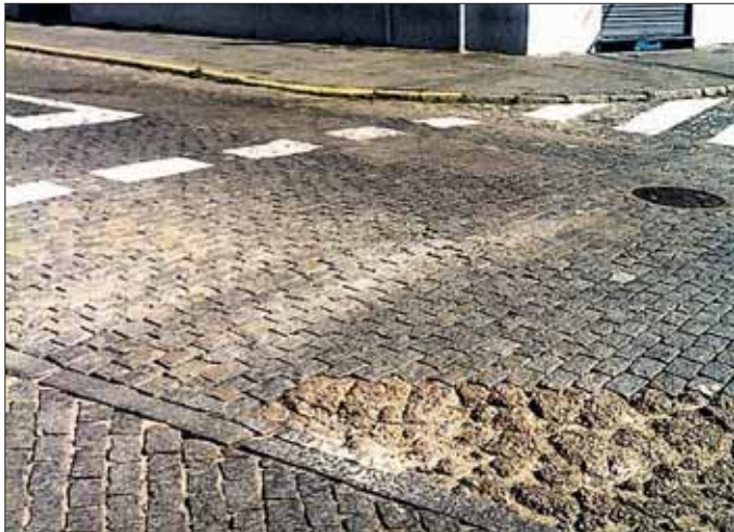
El PP pide el arreglo de las zonas más deterioradas. / EL ADELANTADO
